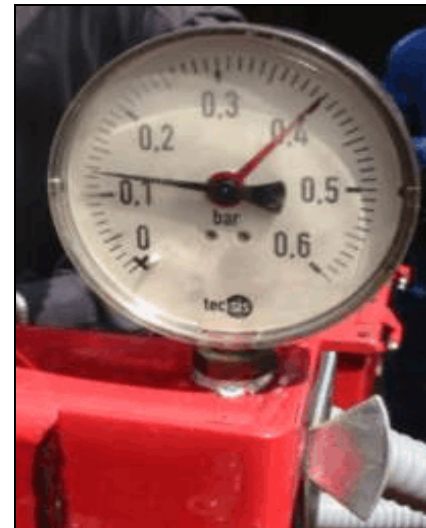
Sl. 3. Ispravno podešen radni natpritisak pneumatske instalacije
